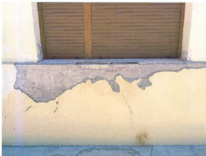
Figura 56. Zócalo de edificio en fachada posterior a patio. El mismo tiene desprendimientos de enfoscado generalizados.
