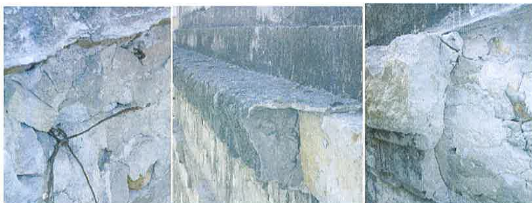
Figuras 8, 9 y 10. Cornisa Llombo con alambre de atado oxidado, recrecidos de mortero suelto, y fractura de soporte por presencia del hierro oxidado en interior.
