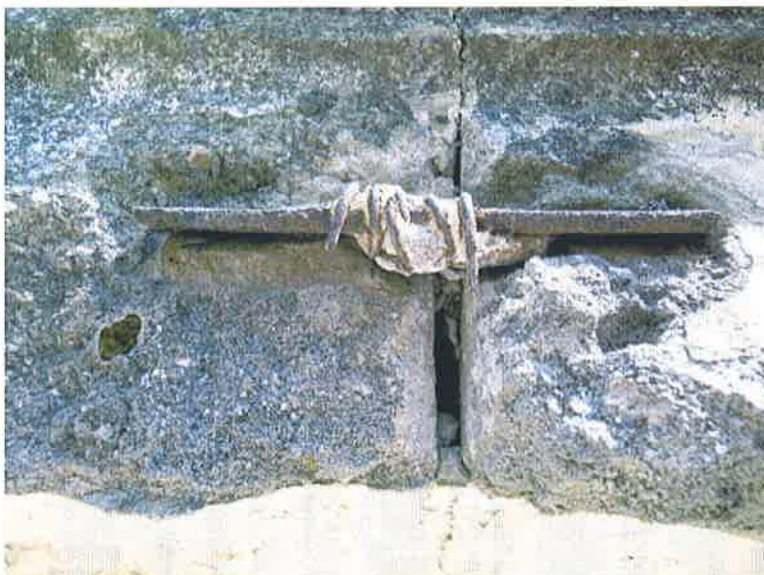
Figura 47. Llave metálica de platabanda a modo de tope, encastrada en ranurado de piezas de mortero cornisa, sustentada por alambre metálico en avanzado estado de oxidación. La expansión ha reventado la piedra artificial y su revestimiento.
