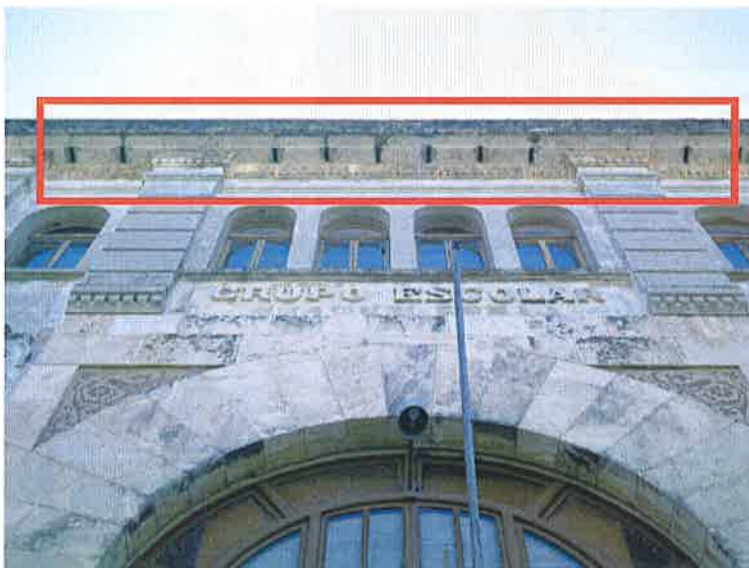
Figura 41. Cornisa cuerpo elevado central fachada principal. Se aprecia en todo el frente de la cornisa la presencia de ménsulas de hierro que han perdido la protección del revestimiento de mortero.
