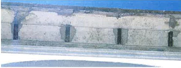
Figura 42. Cornisa mismo cuerpo figura 41. Detalle ampliado con ménsulas de hierro oxidadas en las que apoyan las piezas prefabricadas de mortero armado.
