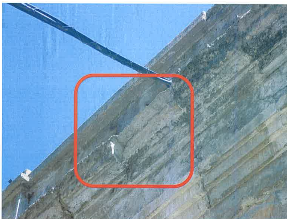
Figura 2. Fotografía de cornisa desprendida en la avenida Llombo
