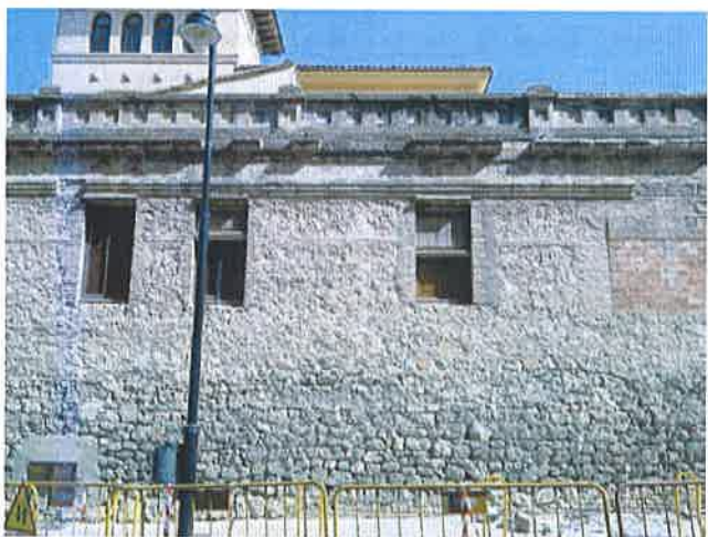
Figura 24. Fachada de mampostería avenida Llombo, con pèrdisas volumètricas de cornisas. La fachada de mampostería presenta ademàs un lavado de mortero de cal muy acusada.
