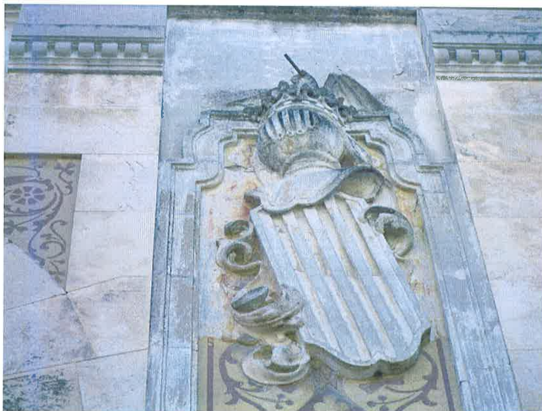
Figura 54. Escudo de piedra artificial con anclajes metálicos para el dragón alado sobre el yelmo. Estos elementos en contacto con el hierro están en peligro de desprendimiento. Se trata de una zona que retiene la humedad, primera causa de ataque al metal.
