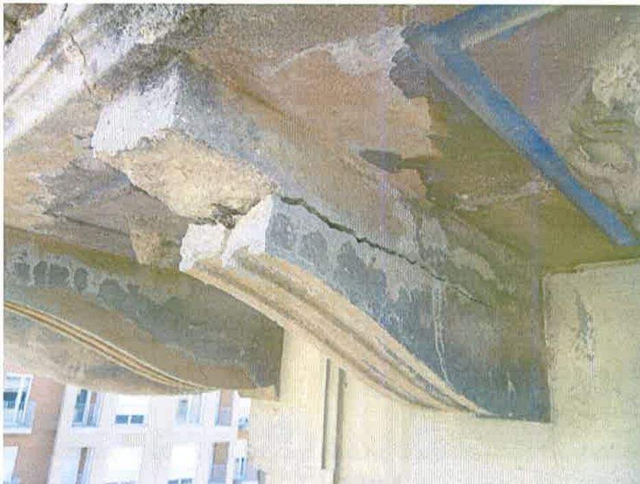
Figura 15. Ménsula de mortero armado con rotura y desprendimiento de material.
