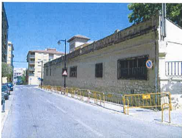
Figura 22. Panoràmica de calle Llombo, en cruce con Echegaray. La zona en general està muy afectada, con pèrdua de gran parte de las piezas molduradas.
