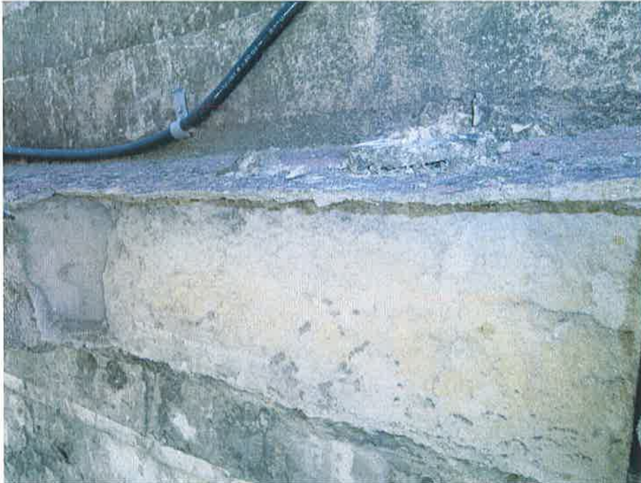
Figura 4. Detalle del tramo de cornisa desprendida.
