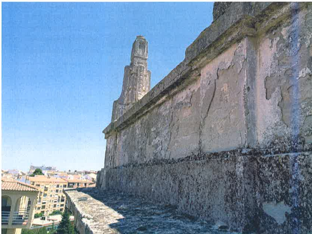
Figura 55. Revestimiento de antepecho en cuerpo central de sobrecubierta. El mortero está desconchado en gran parte de su superficie.
