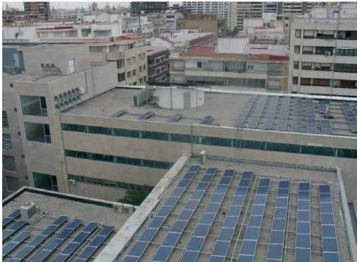
Plaques solars sobre un dels edificis del Campus de Blasco Ibáñez.
