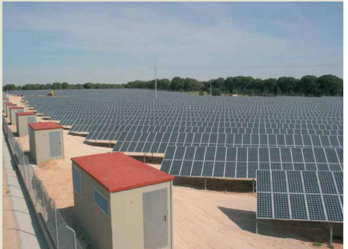
Imatge d'una instal·lació de panells solars.
