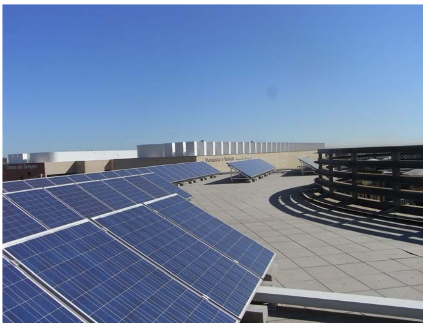
Foto: Instal·lacions fotovoltaiques de l'Edifici de Serveis del Campus dels Tarongers
