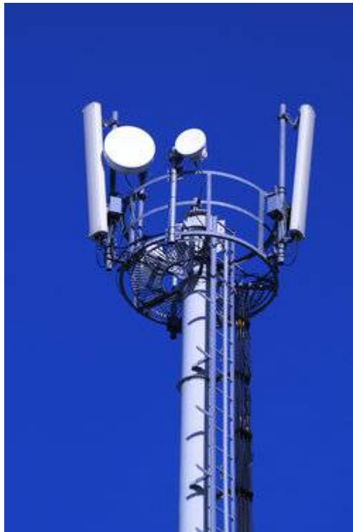
Figura 36. Antena de microondas
