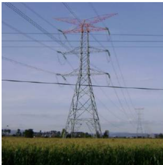
Figura 37. Línea eléctrica de alta tensión
