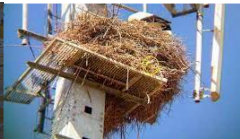
Figura 21. Nidos de Cotorras argentinas afectando a un poste eléctrico
