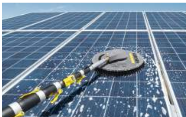
Limpieza de placas solares. [Ilustración 71]. Recuperado de: http://opex-energy.com/fotovoltaica/mantenimiento_fotovoltaico.html
