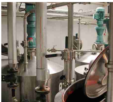
REACTORES DE FABRICACIÓN DE PRODUCTOS QUÍMICOS
