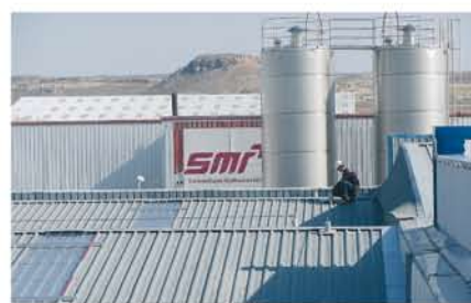
Líneas de vida y mantenimiento de cubiertas
